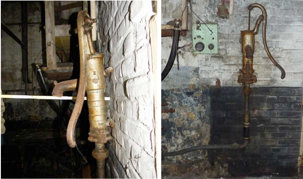
Figuur 10: Waterpomp in de noordoostelijke hoek van het atelier 00.14.
