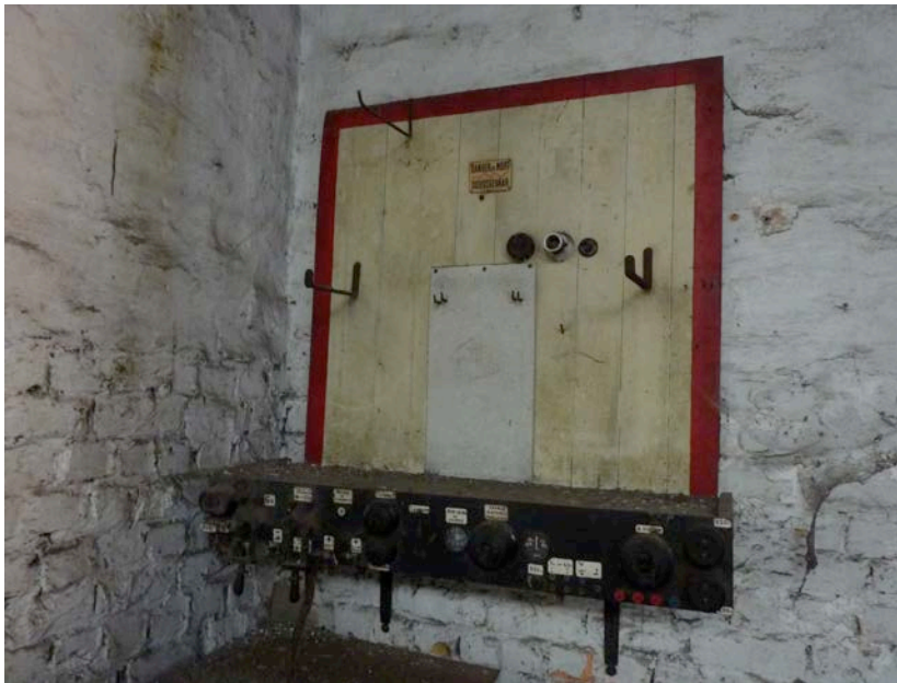
Figuur 9: De elektriciteitscentrale in het atelier 00.14.
