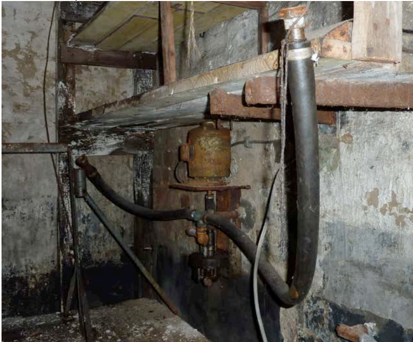
Figuur 11: Pomp in de noordoostelijke hoek van het atelier 00.14.
