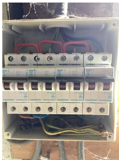
( Elektrisch bord - binnenkant )
