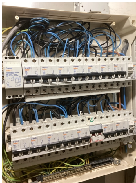
( Elektrisch bord - binnenkant )
