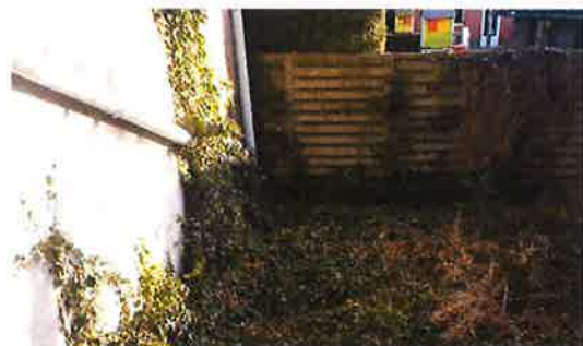
Foto 6: afwatering regengoot asbestdak (zone opslag meststoffen)
