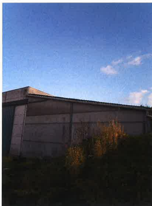
Foto 9: afwatering regengoot asbestdak (zone opslag meststoffen)
