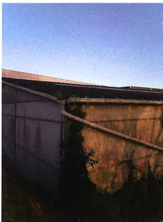
Foto 10: afwatering regengoot asbestdak (zone opslag meststoffen)
