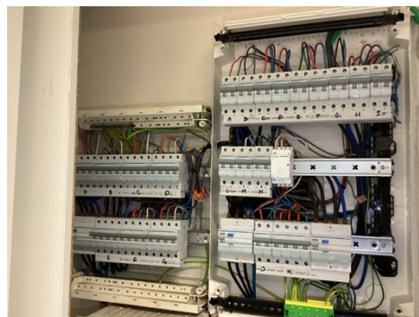
(Elektrisch bord - binnenkant)
