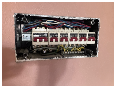
( Elektrisch bord - binnenkant )
