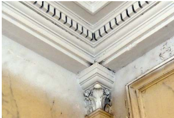
Veeartsenstraat 45-47, voormalige Staatsveeartsenijschool, administratief gebouw, eerste verdieping, detail in de hal, (© ARCHistory, 2019)
