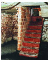
APPARITION DE MOISSURES
