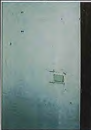
Foto 22: 113: beschadiging (excl. vochtschade) of verwerking / noodzakelijke afwerking ontbreekt
