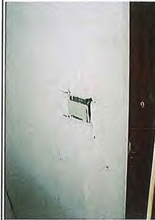
Foto 38: 153: beschadiging (excl. vochtschade) of verwerking / noodzakelijke afwerking ontbreekt
