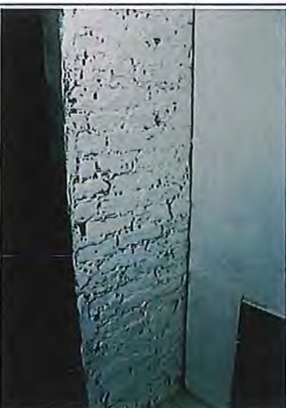
Foto 17: 113: beschadiging (excl. vochtschade) of verwerking / noodzakelijke afwerking ontbreekt
