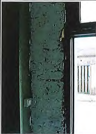
Foto 39: 153: beschadiging (excl. vochtschade) of verwerking / noodzakelijke afwerking ontbreekt
