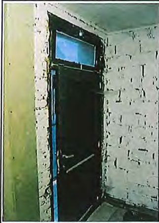
Foto 19: 113: beschadiging (excl. vochtschade) of verwerking / noodzakelijke afwerking ontbreekt
