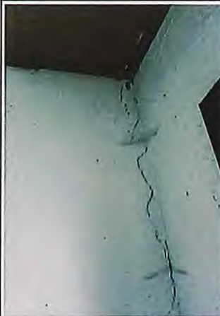
Foto 28: 153: beschadiging (excl. vochtschade) of verwerking / noodzakelijke afwerking ontbreekt
