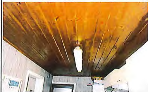
Foto 3: 224: er is onvoldoende ventilatie mogelijk in de functie keuken
