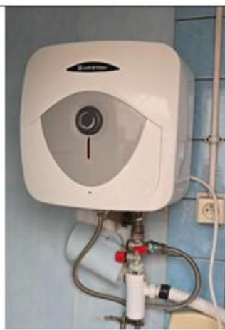
Eau chaude sanitaire (Petit boiler électrique)
