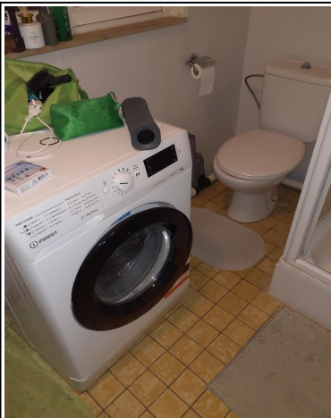
Foto 9: 195: indicatie van een risico op elektrocutie wasmachine te dicht bij de douche
