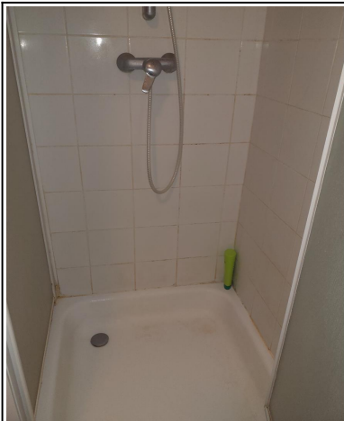
Foto 8: 152: VOCHTSCHADE: condenserend vocht met schimmelvorming
