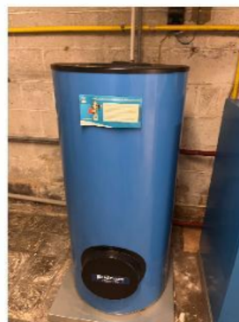
stockage eau chaude
