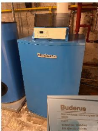
chaudière gaz condensation Buderus Logano Plus 2010
