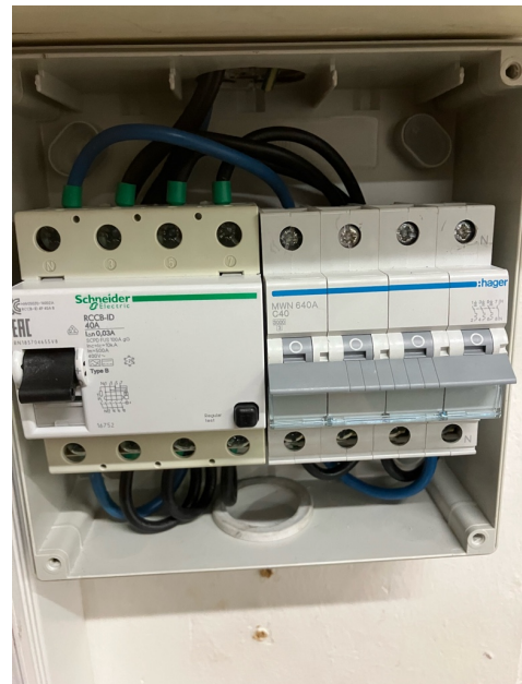
( Elektrisch bord - binnenkant )
