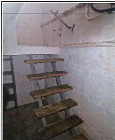
Foto 5: 171: trappen, overlopen, borstweringen met gebruiksonveilige elementen ( te steil / gebreken ...) / trap naar een woonfunctie ontbreekt
