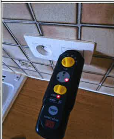
Foto 7: 195: indicatie van een risico op elektrocutie
