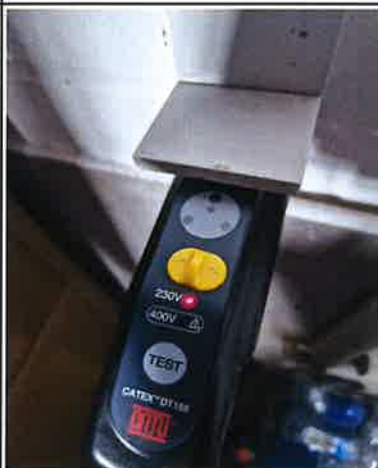
Foto 8: 195: indicatie van een risico op elektrocutie
