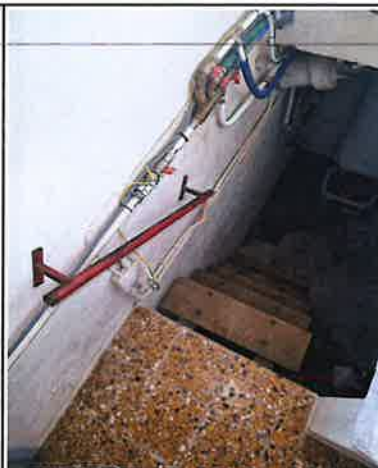
Foto 6: 171: trappen, overlopen, borstweringen met gebruiksonveilige elementen ( te steil / gebreken ...) / trap naar een woonfunctie ontbreekt
