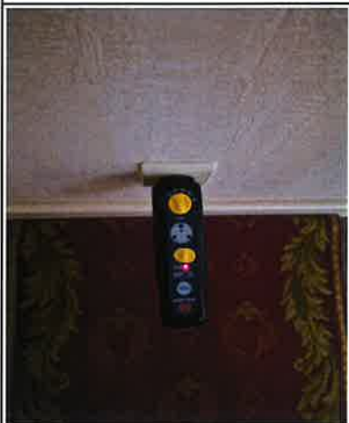
Foto 9: 195: indicatie van een risico op elektrocutie
