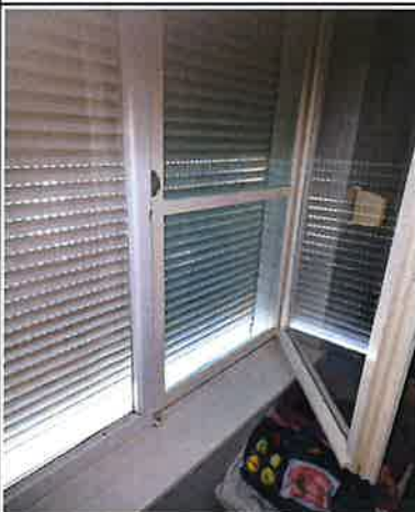
Foto 10: 233: ontbrekende of onvoldoende hoge/stevige borstwering bij lage ramen (vanaf eerste verdieping)
