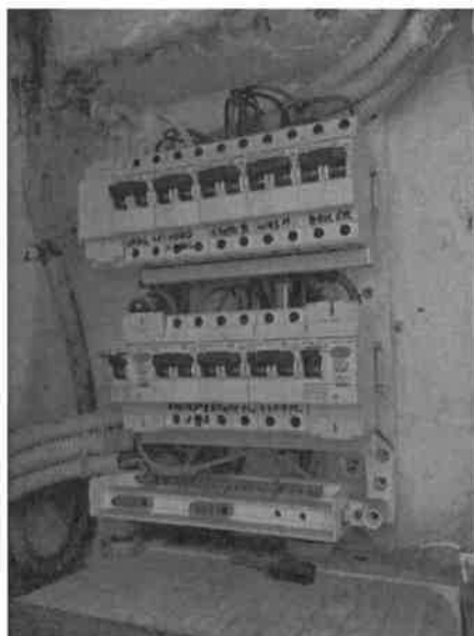
(Elektrisch bord - binnenkant)
