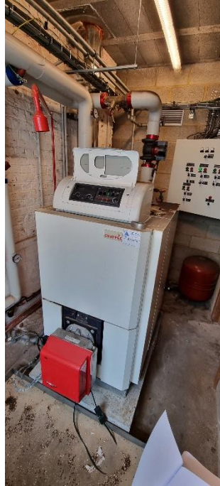
Photo 3 (nouvelle chaudière de l'annexe)
