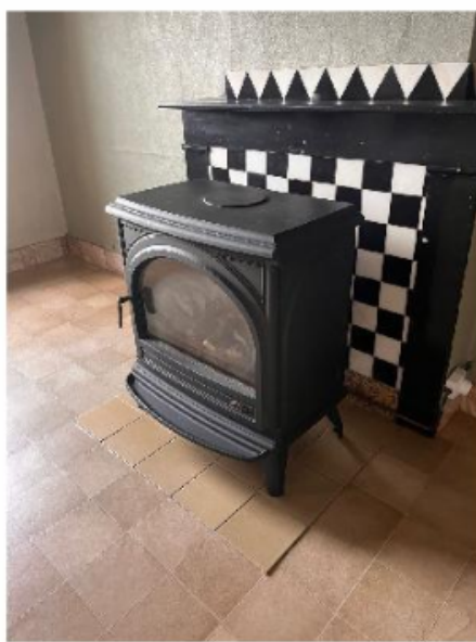
poêle local gaz
