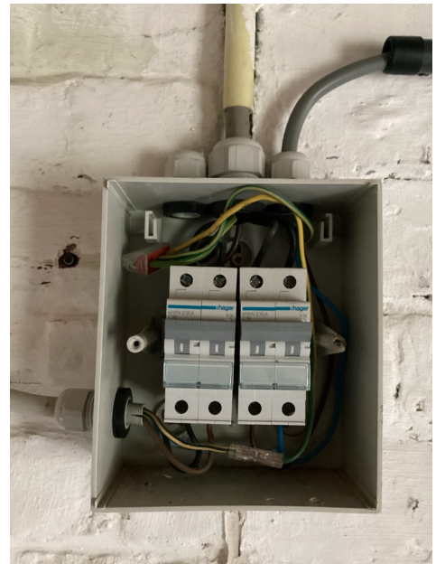
( Tableau électrique - intérieur )
