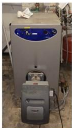
Chaudière Mazout (Chauffage)
