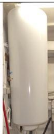
Boiler électrique (eau chaude sanitaire)
