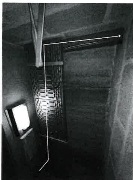
entrée de la fibre optique dans le bâtiments et cheminement du câblage vers l'emplacement du boitier général
