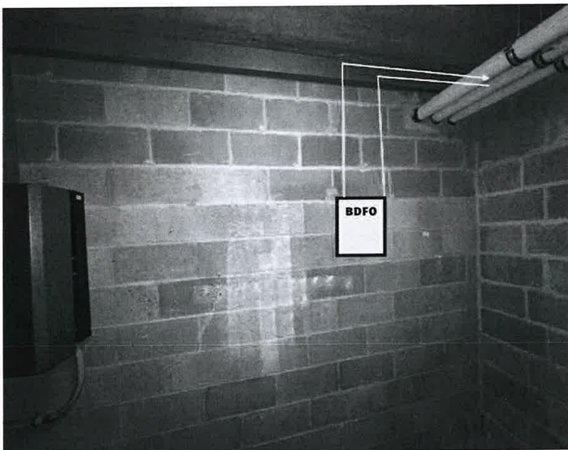
l'emplacement du boitier général de la fibre optique
